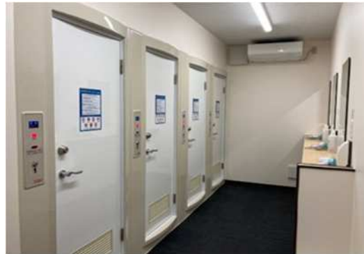
シャワー設備
